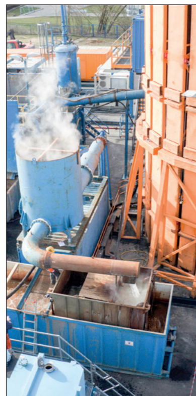
Der Dampf der gerade geförderten Thermalsole ist hier gut sichtbar
