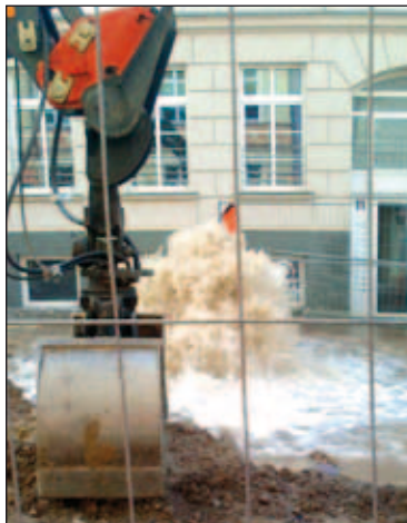
Beim Rohrbruch ist schnelles Handeln gefragt Foto: WAG
