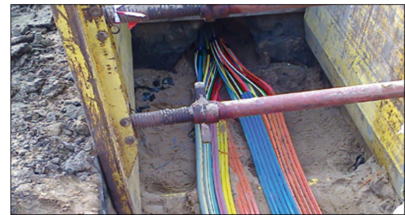
Bis Ende 2017 soll die Erschließung der Werdervorstadt mit Glasfaser abgeschlossen sein Foto: Stadtwerke
