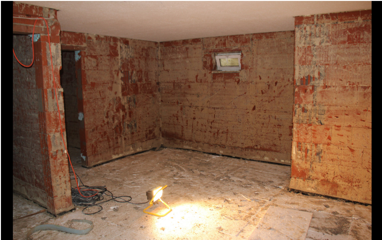
Der Keller stand bis unter die Decken unter Wasser
