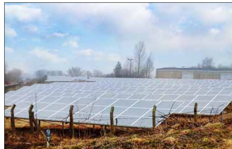
Auf dem Gelände des ehemaligen Wasserwerkes in Gosewinkel steht nun eine Photovoltaikanlage, mit der Strom aus Sonnenenergie gewonnen wird. Foto: SWS
