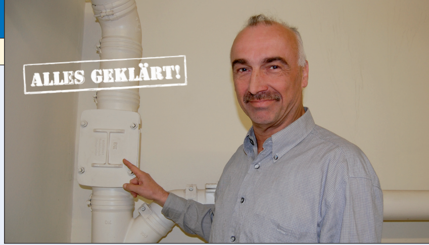
Lothar Jäger, bei der SAE für das Anschlusswesen zuständig, zeigt hier eine Revisionsklappe. Diese kann geöffnet werden, um Rohre bei Bedarf zu reinigen. Foto: maxpress/mw
