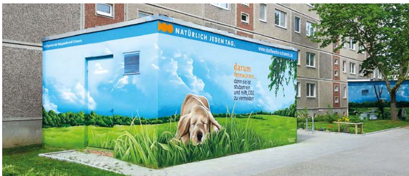
Fernwärmemaskottchen ziert nun auch die Fernwärmeübergabestation in der Ziolkowskistraße
