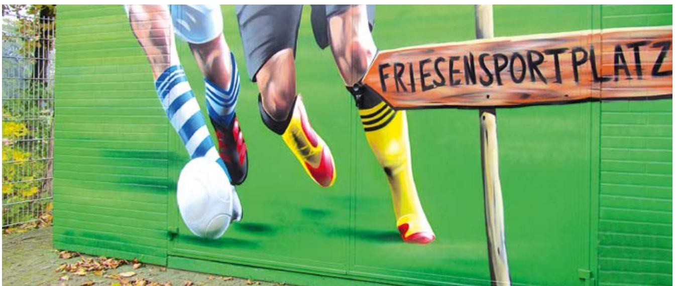
Die Gasdruckregelstation am Friesensportplatz wurde in einen echten Hingucker verwandelt
