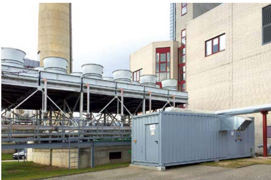
Neue Wärmepumpe am Energiestandort Süd (ausser)
