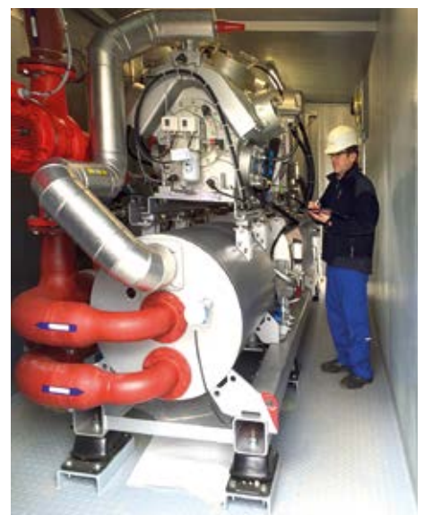
Neue Wärmepumpe am Energiestandort Süd (innen)
